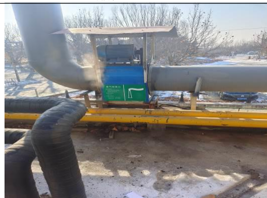
排放口 (DA001) 标识牌
