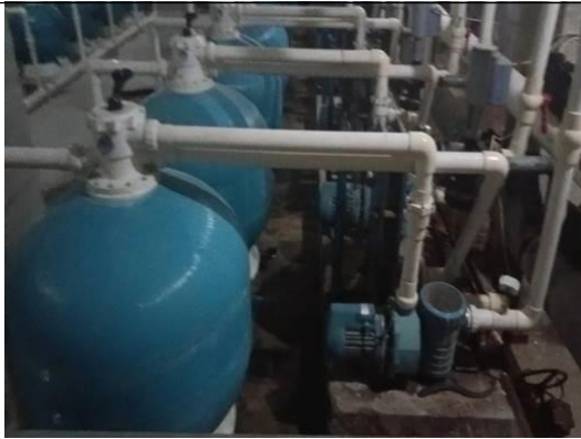
温泉水过滤装置
